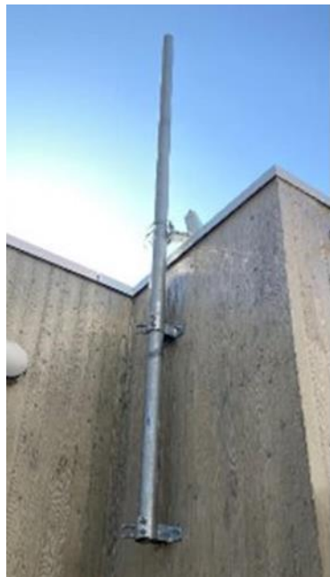
5Gアンテナ設置用のポール
