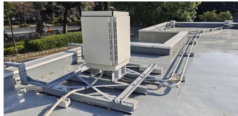
ドコモ5G無線機用キャビネット及び配管
