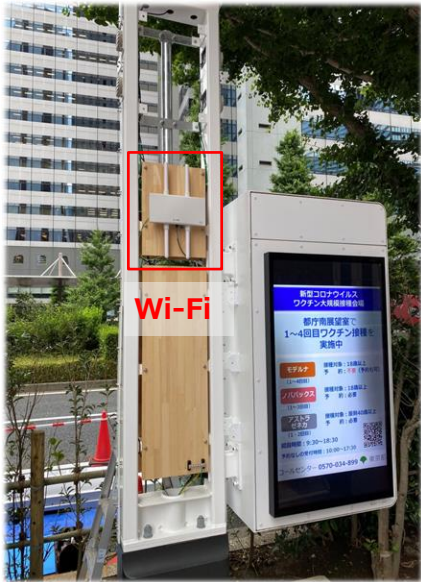
スマートポール（サイネージ） Wi-Fi AP設置(例)
