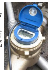
▲水道管に取りつけられたスマートメータ
