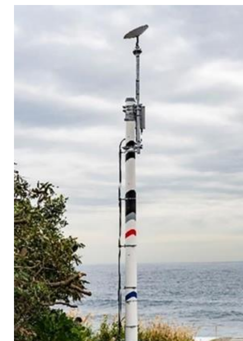
衛星通信を活用した基地局
