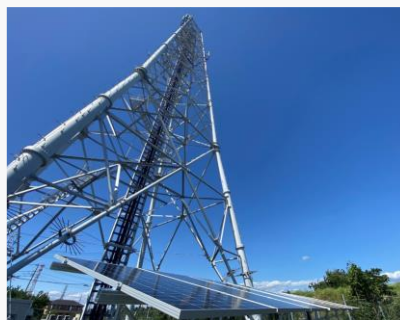
太陽光発電を電源にした基地局
