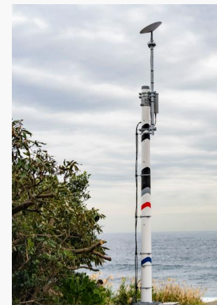
衛星回線を活用した基地局
