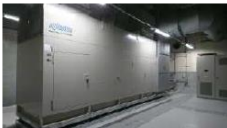
非常用発電設備*10
