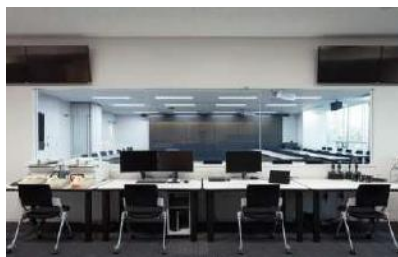
防災センター(中央管理室)*10
