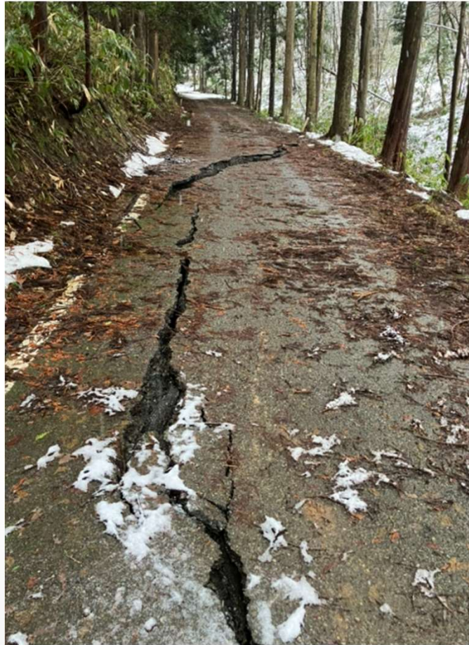
輪島市県道271号線付近
