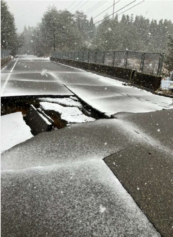
輪島市県道333号線付近
